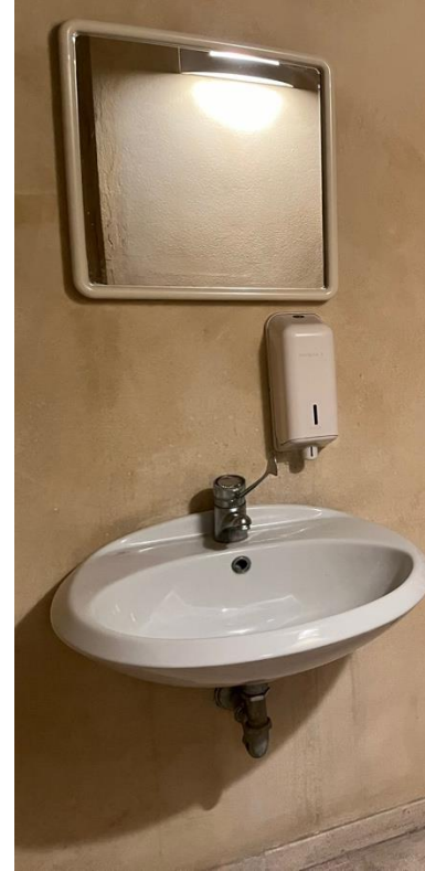
Assenza di misure e spazi sufficienti per l'accostamento delle carrozzine
